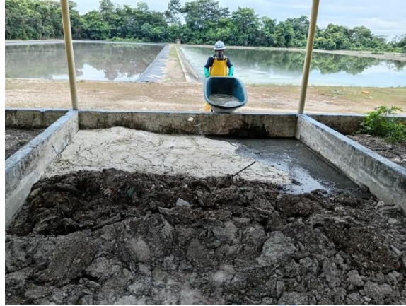
Tratamiento de los lodos en el lecho de secado
