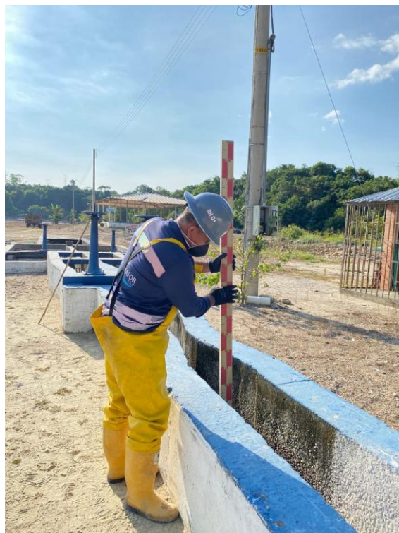
Toma de caudal en el sistema primario
